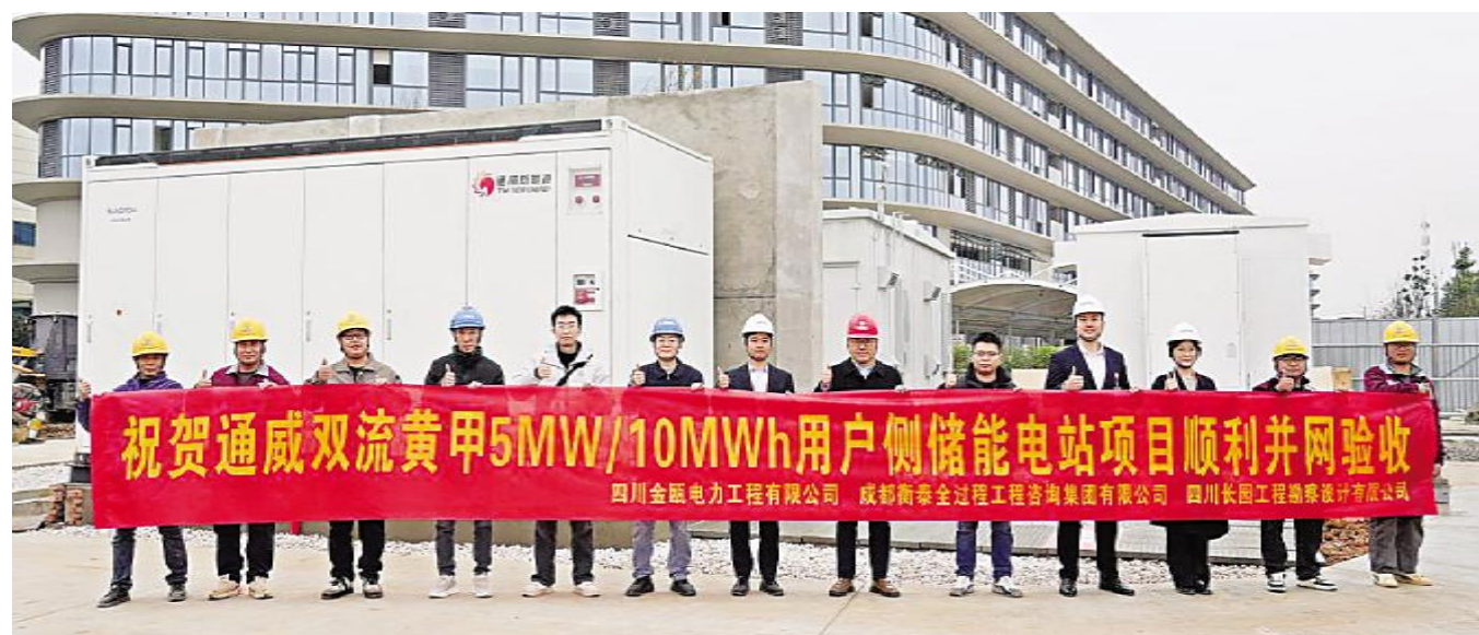
通威双流黄甲 5MW/10MWh 用户侧储能电站成功并网投运
