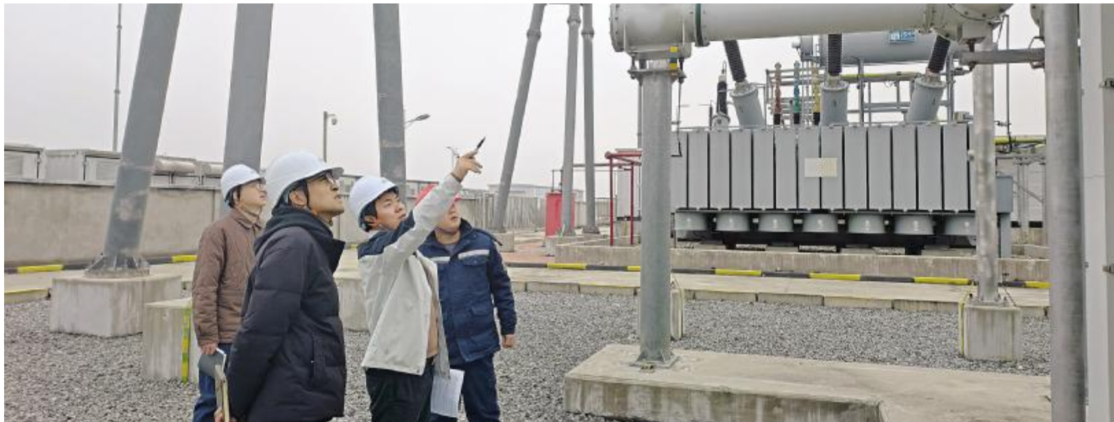
通威新能源北京公司开展春季安全大检查
