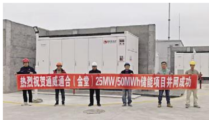
金堂通合 25MW/50MWh 用户侧储能项目成功并网投运
