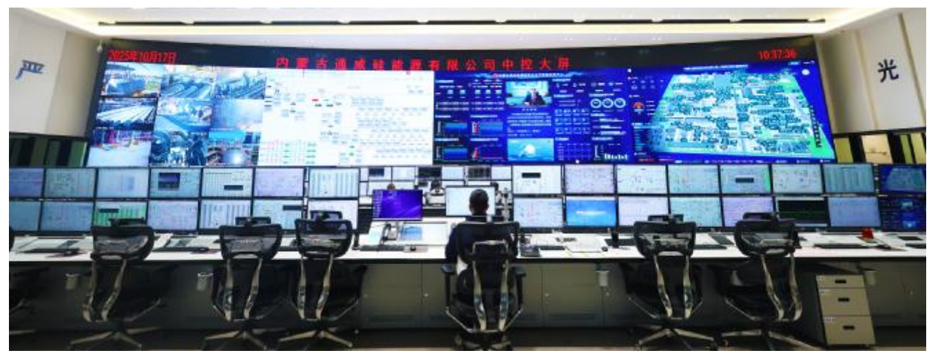
通威硅能源(内蒙古)中控室
